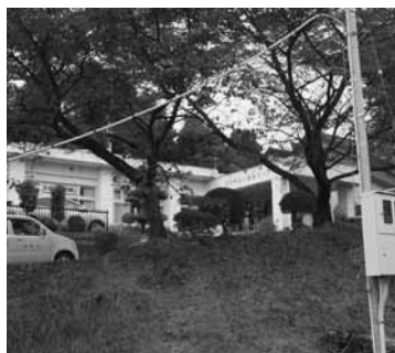
修繕が必要とされる健康センター
