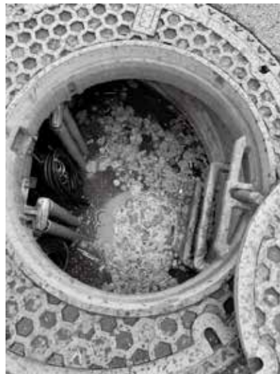
詰まった状態の下水道施設
