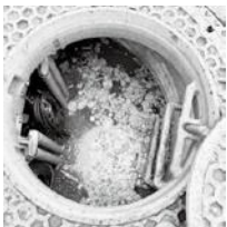
詰まった状態の 下水道施設
