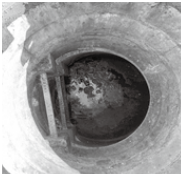
詰まった状態の下水道施設
