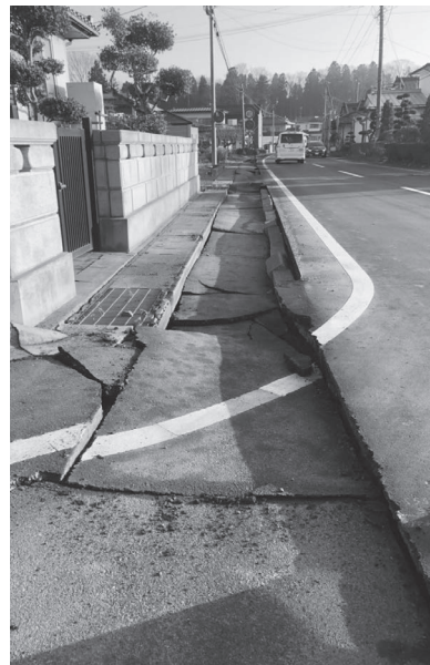
大和内地区の地盤沈下
