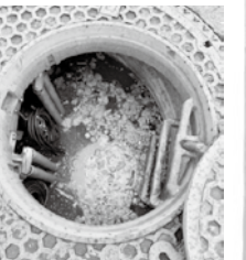
詰まった状態の下水道施設
