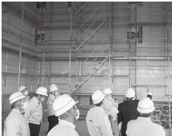
あゆり温泉の被災状況
