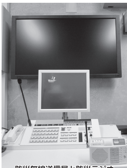
防災無線送信局と防災ラジオ
