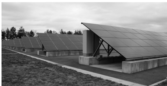
ソーラー発電パネル（レンゴー株式会社福島矢吹工場）
