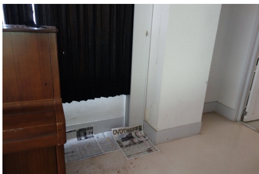
大ホール 壁面からの雨漏
