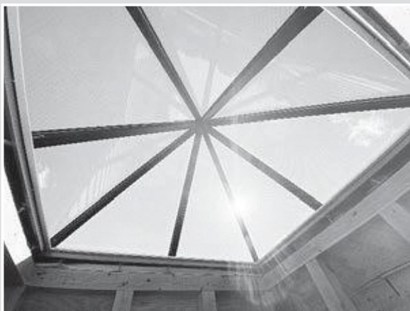
▲トップライト設置状況
