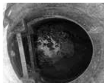
詰まった状態の下水道施設
